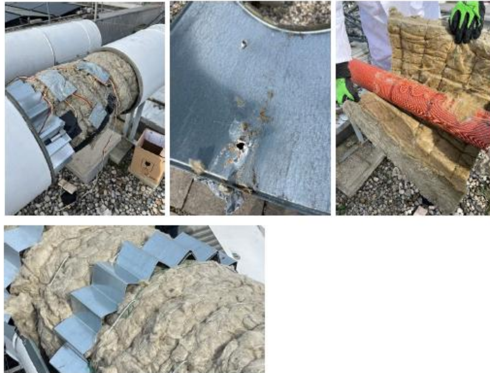
Bild 7: Geöffnetes Rohrdämmsystem mit Luftspalt.
