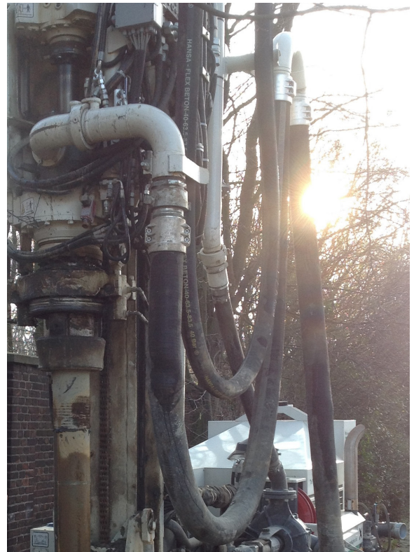
Bohranlage ohne Fangeinrichtung
