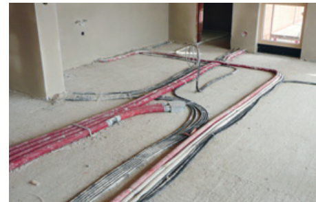
Rohrleitungen auf der Rohdecke
