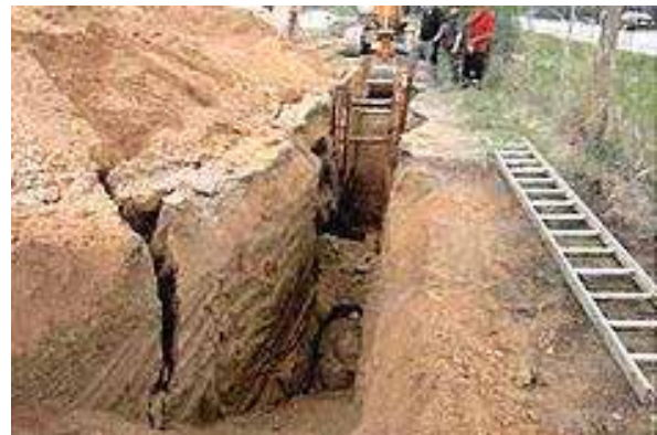
Abb. 6: Lokaler Böschungsbruch mit annähernd böschungspareller Gleitfuge [2]
